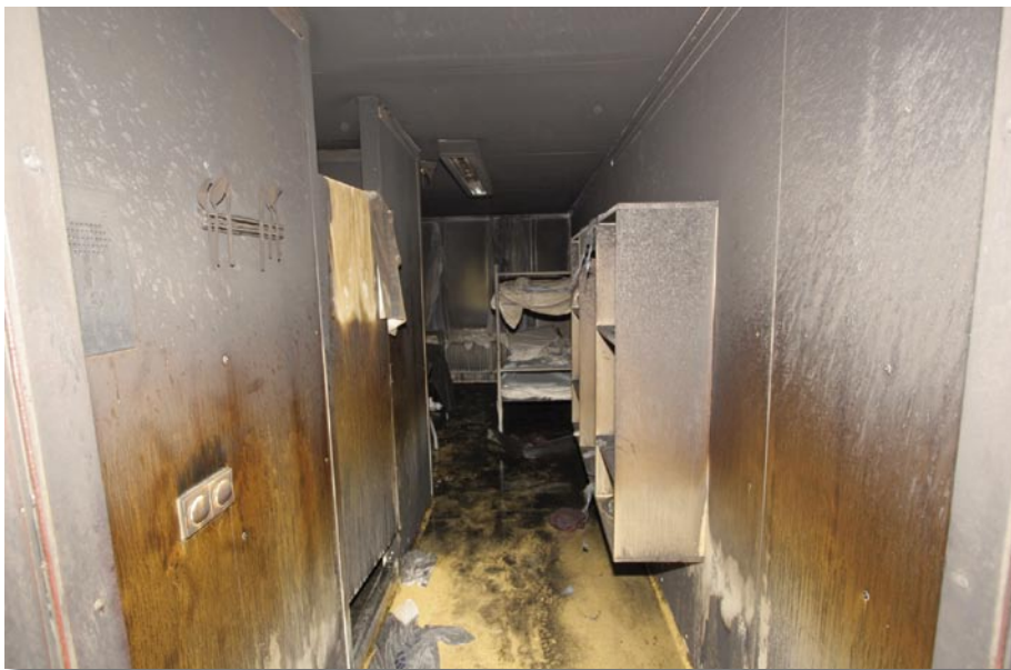
Figuur 22: Interieur cel K-1, met aftekening rookgaslaag op wanden
